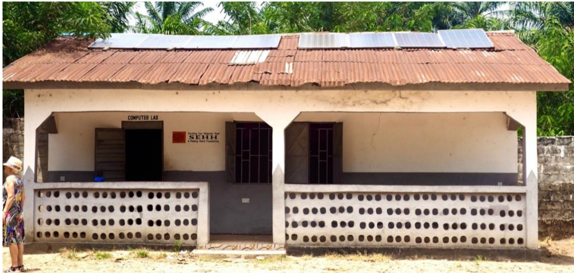
Het 'SEHH'-computergebouw, nu voorzien van zonnepanelen (met als gevolg een lekkend dak...)
